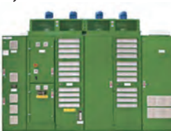
AC/DC Power Converter AC/DC電力変換装置
